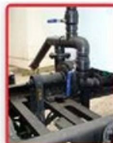
Succión y Descarga de Incendio
