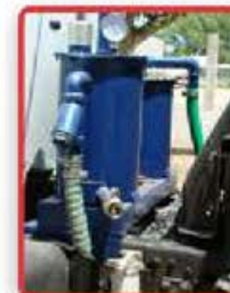
Tanque para aceite y trampa de agua
