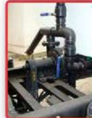
Succión y Descarga de Incendio
