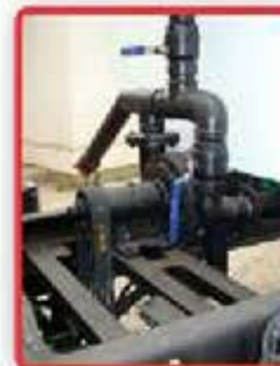
Succión y Descarga de Incendio
